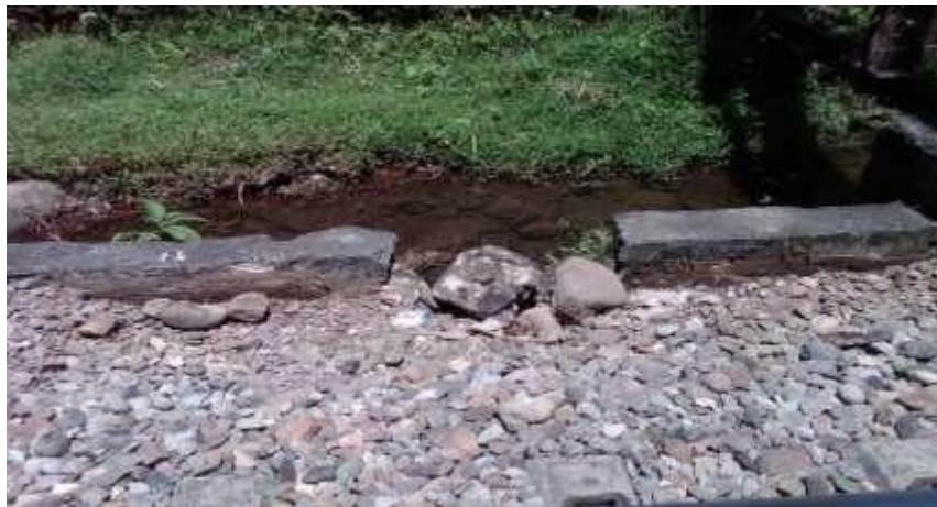
Gambar 6. Tanggul yang runtuh
